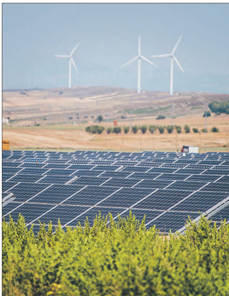
Una central fotovoltaica. ISTOCK
